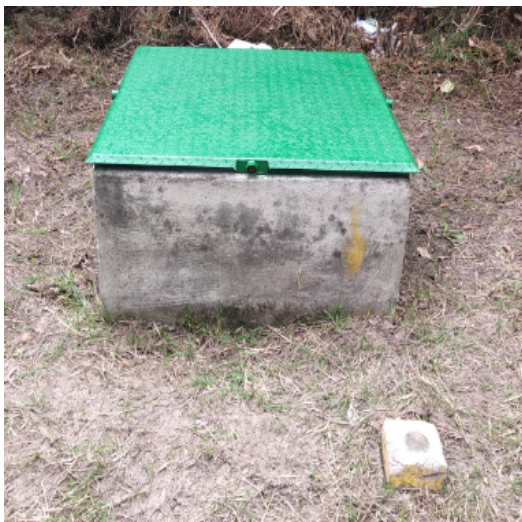
Fotografía 2. Estado físico y ambiental de la caja que protege la boca del pozo y su entorno
